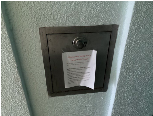
Trash chute door
